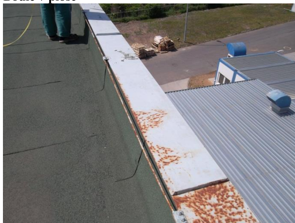
Koroze oplechování po obvodě
