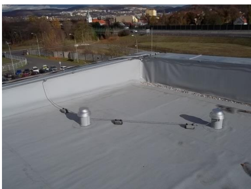
Vakuové ventily v rohu
