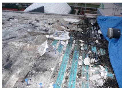
Ohořelé části střešního pláště
