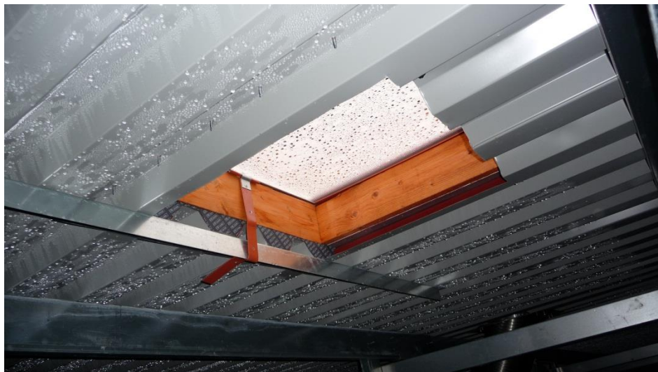
Obr. 6: Nový střešní výlez
