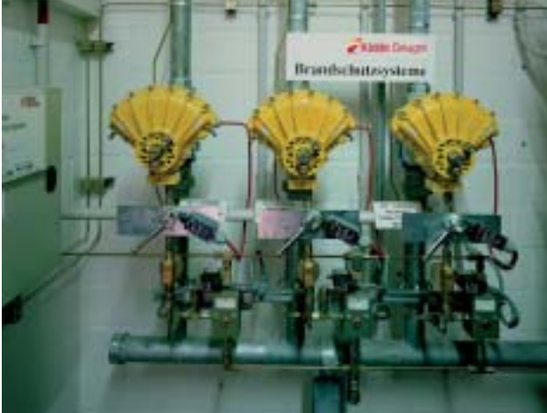
Sekční ventily vysokotlakých hasicích zařízení
