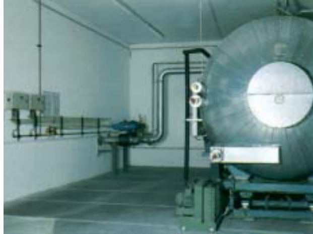
Nízkotlaké zařízení CO 2 s ústřednou, pneumatickým zpožďovacím zařízením a sekčními ventily
