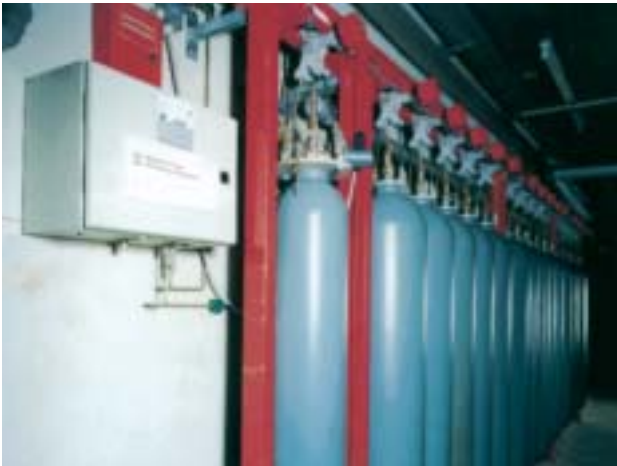
Vysokotlaké zařízení CO 2 s pneumatickým zpožďovacím zařízením
