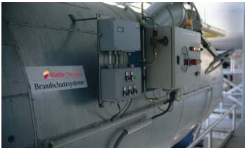
Zásobní kontejner CO 2 s rozváděčem
