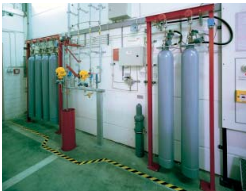
Baterie lahví CO 2 se sekčními ventily a pneumatickou zpožďovací jednotkou
