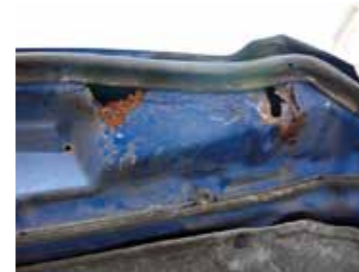
Ventilační otvory jsou i ve dveřích a kapotě. Špatně umístěné však nepomohou.
