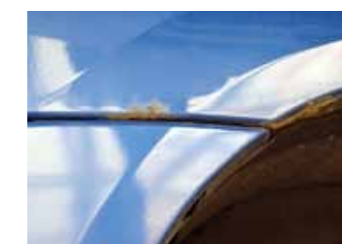
Počínající koroze se opravuje snáz než pokročilá, nepodceňujte prevenci
